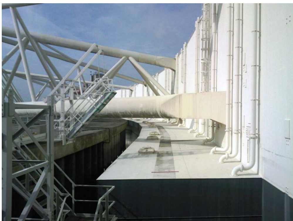
Figuur 7; 'deur' van de Maeslantkering
